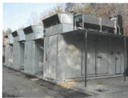
Impianto di recupero energetico biogas
