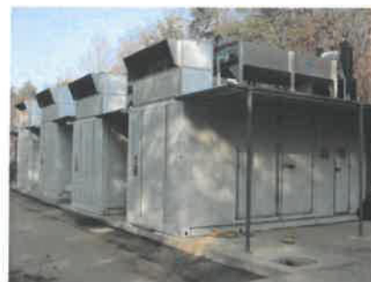
Impianto di recupero energetico biogas
